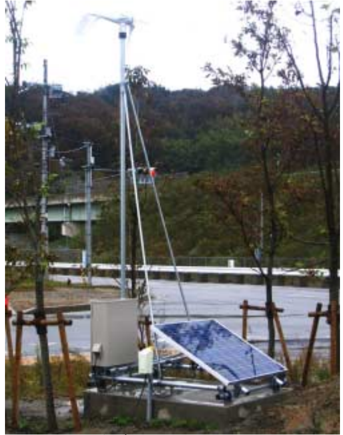
水循環ポンプ駆動用の太陽光・風力発電設備
