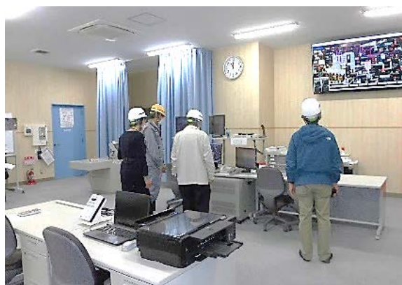
発電所全自動監視・制御
