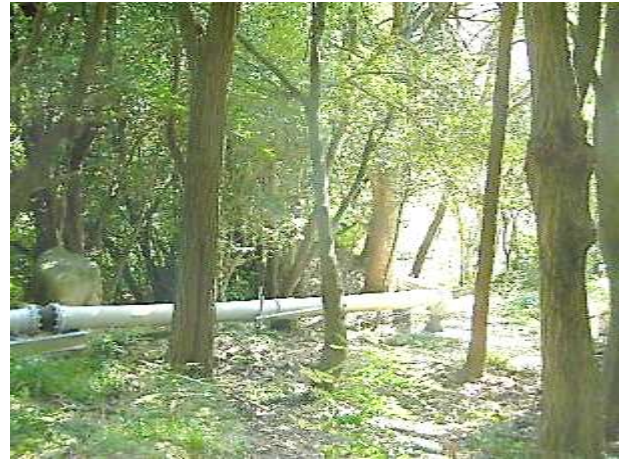
除塵タンクと水車・発電機との間のVP管
