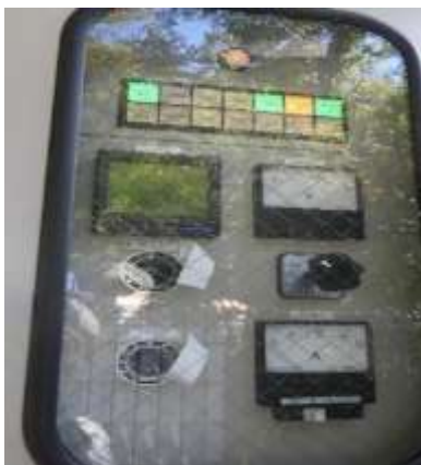
システム制御盤
