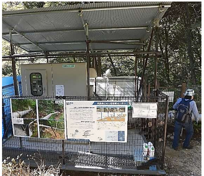
水車・発電機 手前側より
