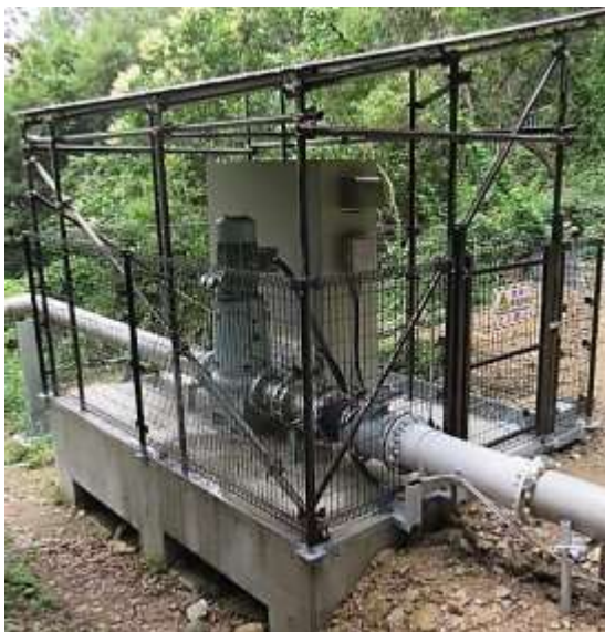
水車・発電機 裏側より
